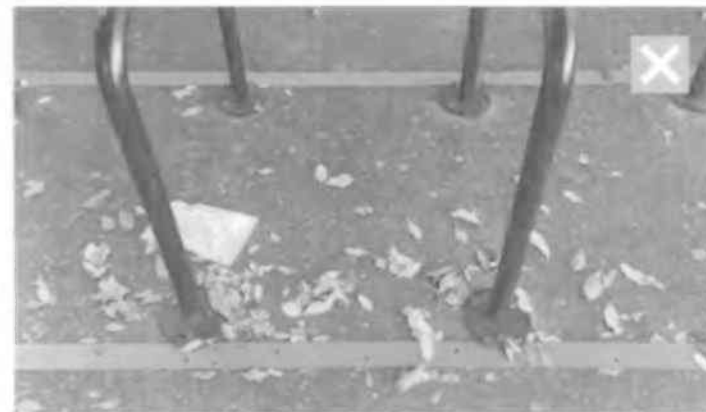
✗ Nehodné povrchové kotvenie cyklostojanov skrutkovými ocelovými patiek do asfaltu v kombinácii s navarenými pásovnicami
